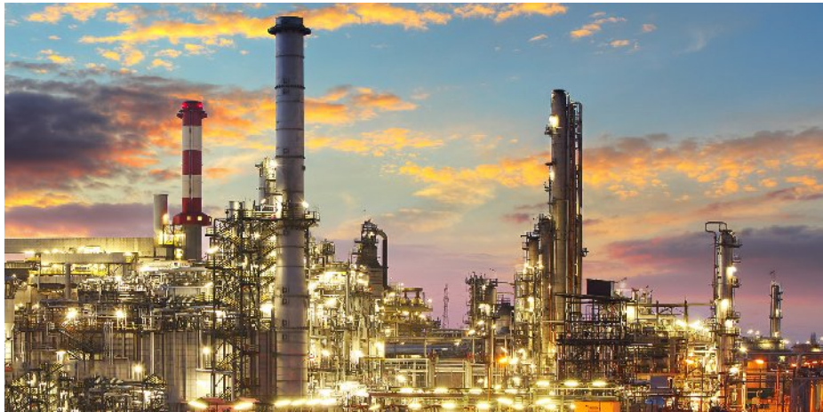
Figure 4.5. Raffinerie pleine de chaudière
