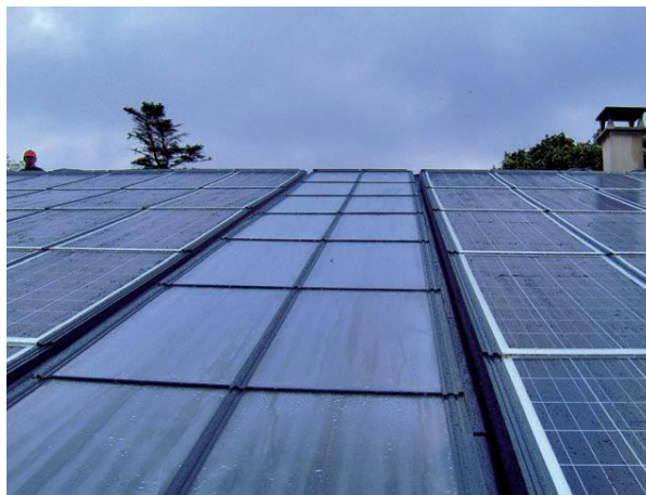
Fig.2.5. Capteurs solaire plan et panneaux photovoltaïques
